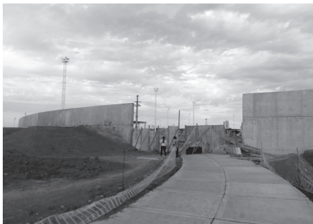
Gráfico 4. El muro en construcción. Vista de la abertura prevista para el ingreso de vehículos aduaneros y de seguridad.
