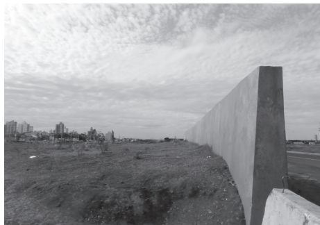
Gráfico 3. El muro en construcción. A la izquierda la ciudad de Posadas. A la derecha, la delimitación del área aduanera.
